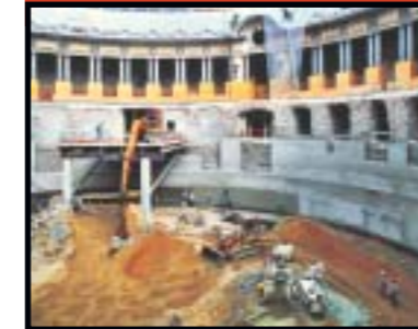
Création d'un auditorium sous la cour centrale du Petit Palais dans le cadre de la restructuration de ce musée parisien orchestrée par le cabinet Chaix & Morel
