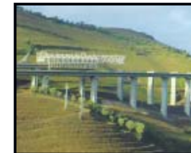
Construction de l'un des trente quatre ouvrages d'art qui jalonnent le tracé autoroutier Norscut au Portugal.
